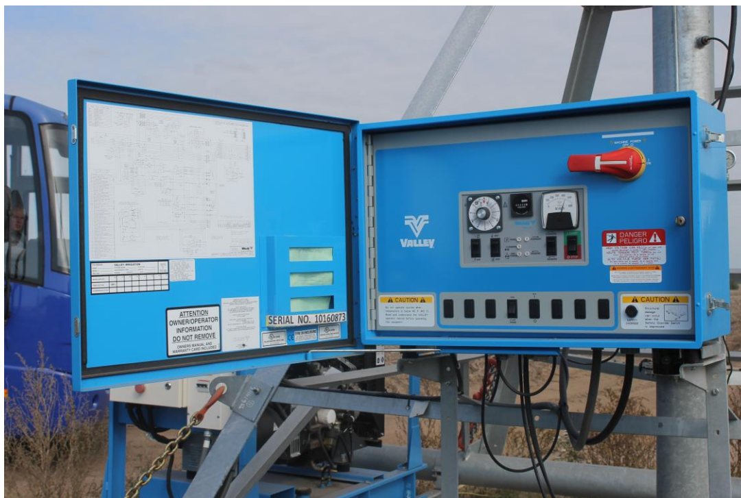
Панель управления на центральной опоре дождевальной машины Valley, д. Васьковичи
