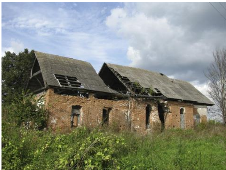
Рис. 10. Разрушенное здание храма Михаила Архангела в с. Упорой
