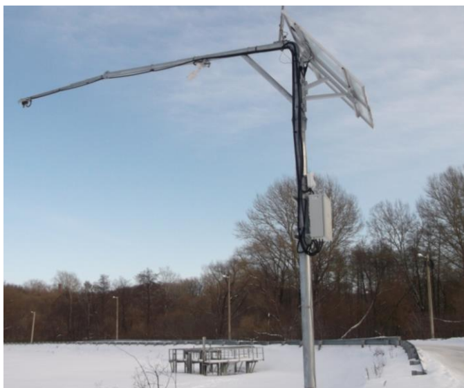
Рисунок 1 - Мониторинговая станция уровня воды пруда с. Кокино
