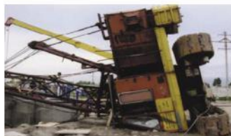
Рис. 1. Авария гусеничного грузоподъемного крана в результате опрокидывания
