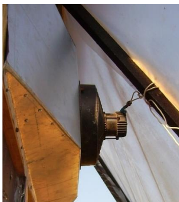
Рисунок 6 – Осевой вентилятор резервной системы вентиляции
