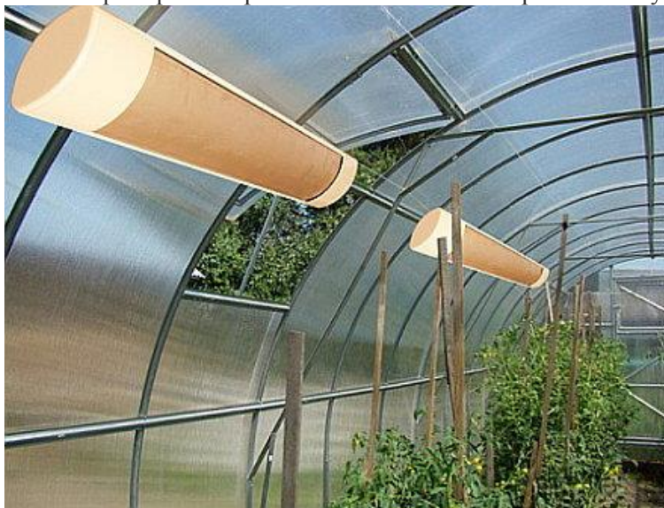
Рис. 5.5 Расположение обогревателей в теплице
