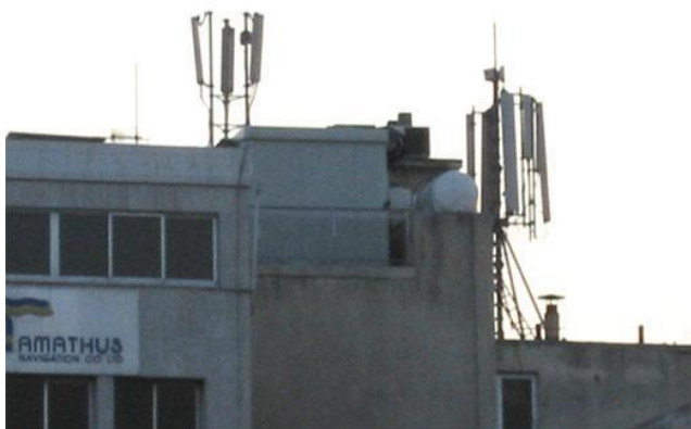
Рисунок 5.1 - Базовая станция на крыше здания
