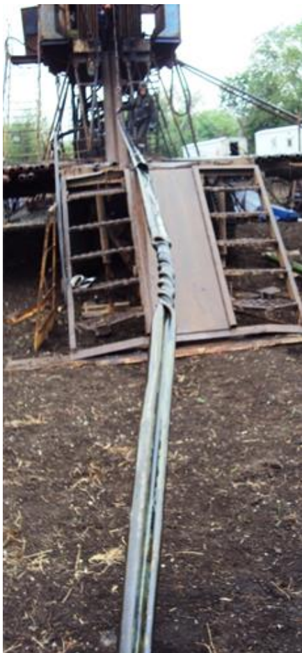
Рисунок 2 - Бурильный инструмент извлеченный из скважины после ликвидации аварии
