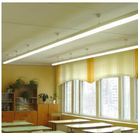
Рис.2. Общий вид светильника в помещении
