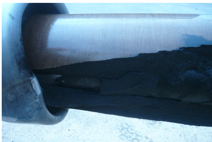
Рис. 1. Иллюстрация низкого качества изготовления ввода 330 кВ с RIP-изоляцией. Взрыв ввода в баке трансформатора (фото авторов работы с места аварии)
