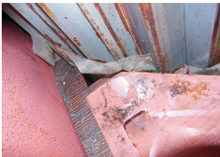
Рис. 2. Низкое качество ремонта трансформатора: загрязнение поверхности отдельных узлов трансформатора вызвало частичные разряды порядка 1000 пКл, сработала газовая защита (фото авторов работы с места аварии)
