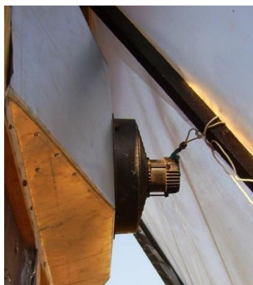
Рисунок 6 – Осевой вентилятор резервной системы вентиляции
