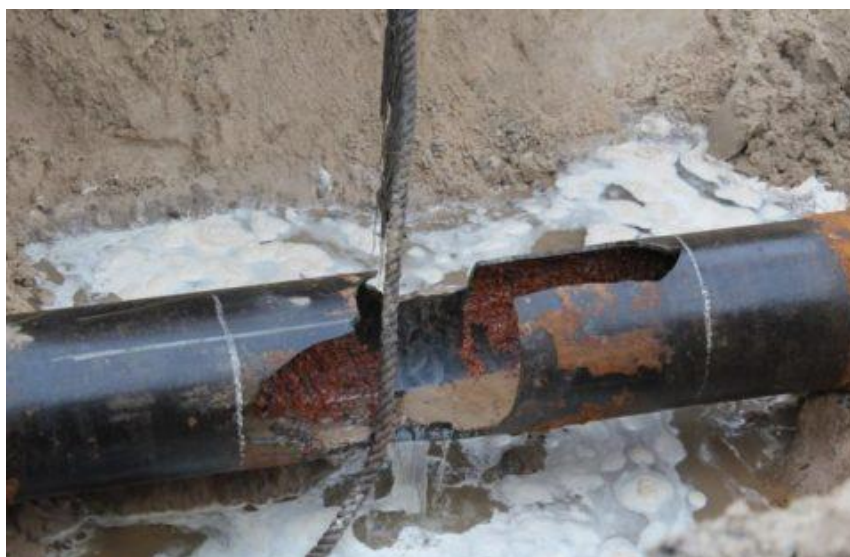
Рисунок 2 - Прорыв трубы – аварийная ситуация
