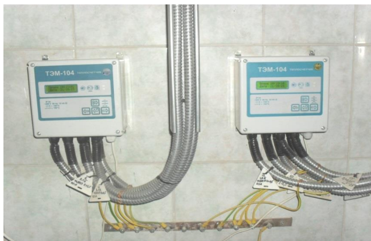
Рисунок 1 – Внешний вид счетчиков тепловой энергии установленных на предприятии
