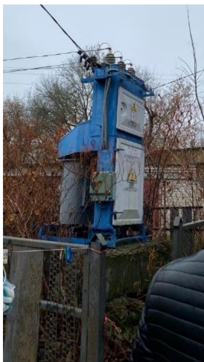
Рисунок 4 – Трансформаторная подстанция 10/0,4 кВ
