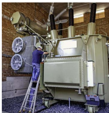
Рисунок 2 – Проверка работоспособности вентиляторов трансформатора и радиаторов по программе технического обслуживания
